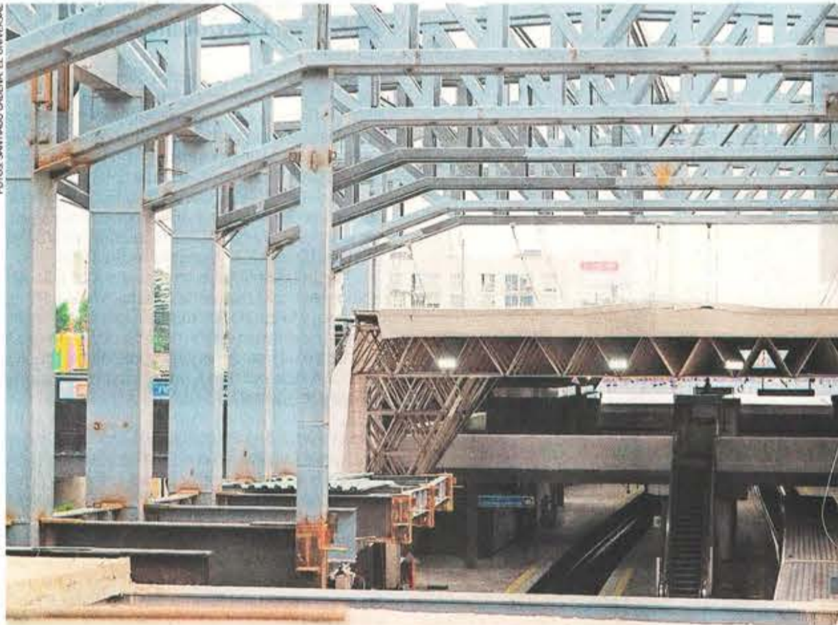
El Jardín Flotante Tlalpan fue abierto sin que la estructura estuviera completa; le falta la conexión con la estación Chabacano.
